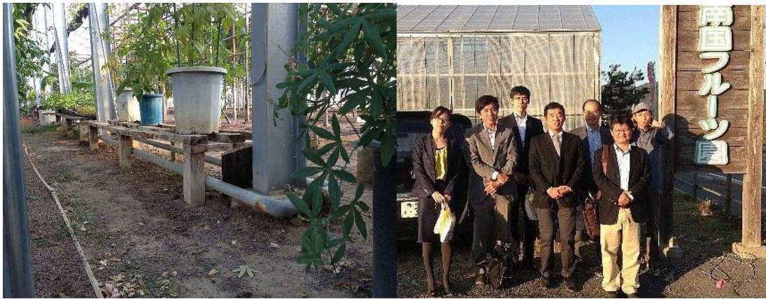
温室内温水配管
