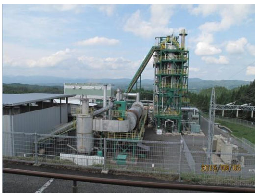
(燃焼塔と燃料移送コンベア)
