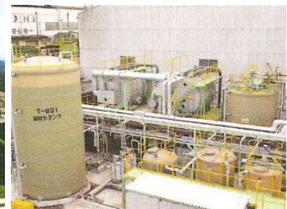
排水濃縮結晶化設備)
